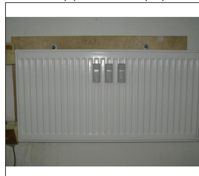
Фотография отопительного прибора
