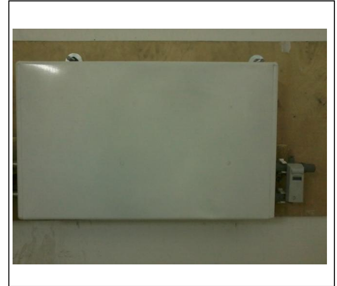
Фотография отопительного прибора
